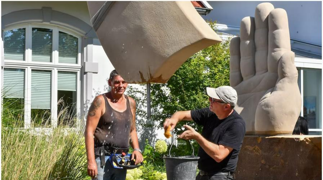
Der Bildhauer Jürgen Waxweiler (rechts) trinkt den einzubauenden Stein am Fuß mit Wasser, damit dieser sich mit dem Mörtel auf dem Sockel verbinden kann. Der Kranführer Bernd Ströher lenkt millimetergenau den Lkw-Kran. Foto: Vollmer
